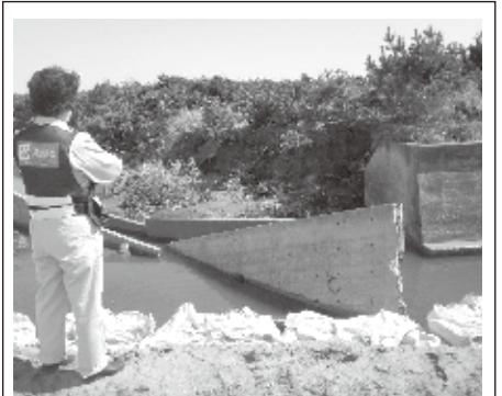
千葉県旭市の三川河口。コンクリートの護岸が破壊されていた。
